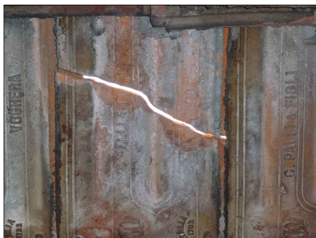
Foto in primo piano di una delle molteplici marsigliesi danneggiate
